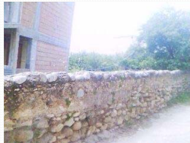
Vecchio muro in pietre post-sisma
